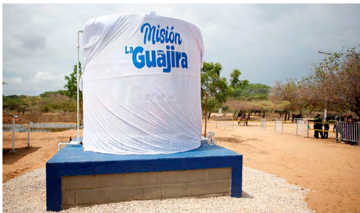
Uno de los tanques de almacenamiento de la planta potabilizadora de agua que beneficiará a tres comunidades wayuu de Manaure, entregada por la estrategia Misión La Guajira.
